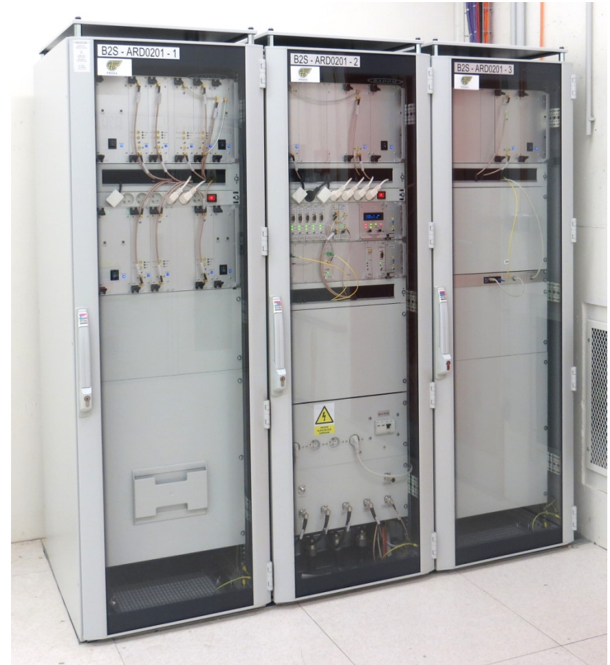
Technologie jednoho ze stanovišť tunelového komplexu Blanka
